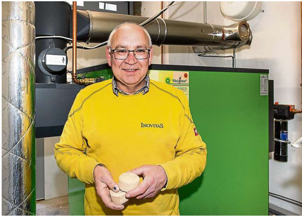
Erhalt oder gar Rekonstruktion: keine Option für die in die Jahre gekommene Holzheizung in der rund 800 Quadratmeter großen Werkstatt von Jürgen Rüdiger. Bei der Suche nach einem modernen Heizsystem erhielt er Unterstützung von der Wirtschaftsförderung Wetterau. Foto: Kuhl
